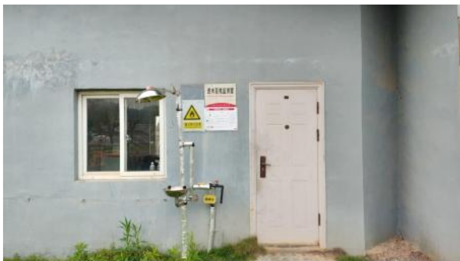
图 10-7 废水进口在线监测
