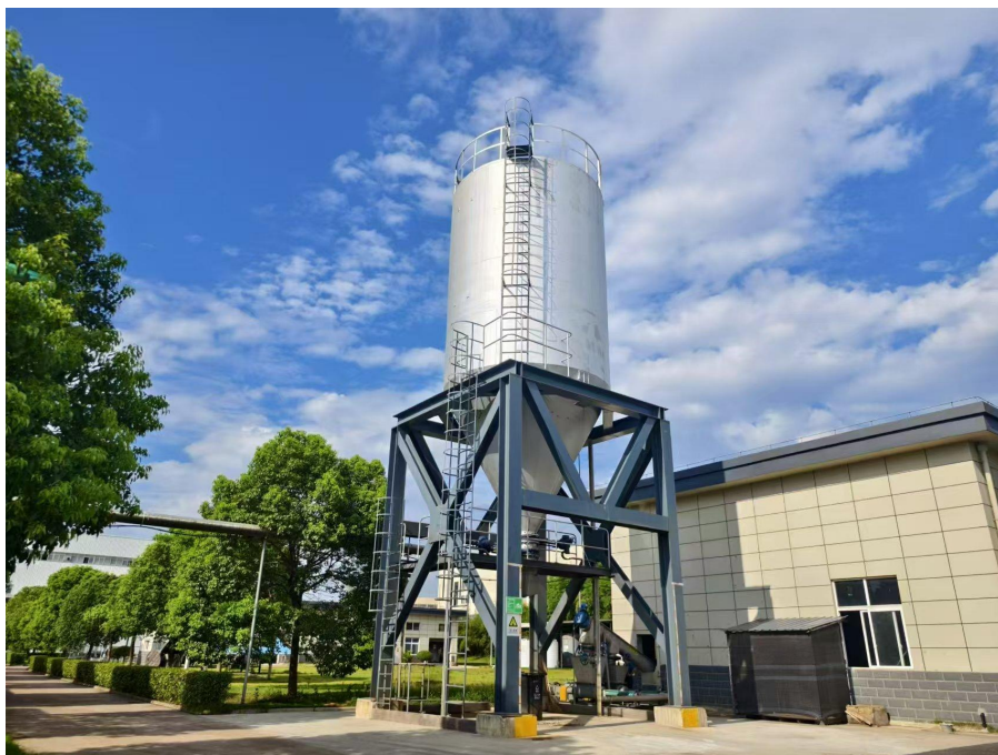
图 10-3 项目污泥暂存料斗
