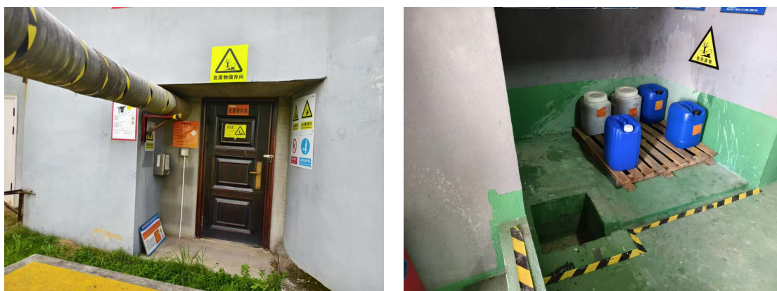
图 10-2 项目危废暂存间
